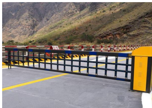
12.2-12 施工便桥桥头门禁系统
