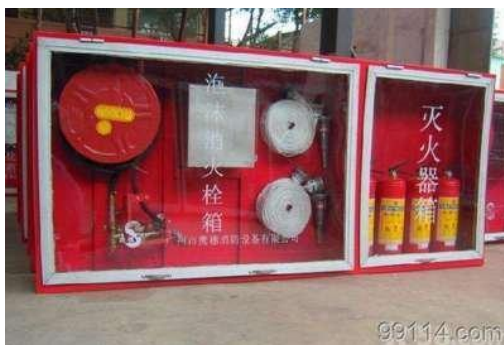
7.6.4-1 泡沫灭火栓和灭火器
