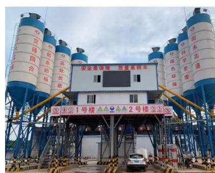
10.3.1-2 水泥混凝土搅拌楼
