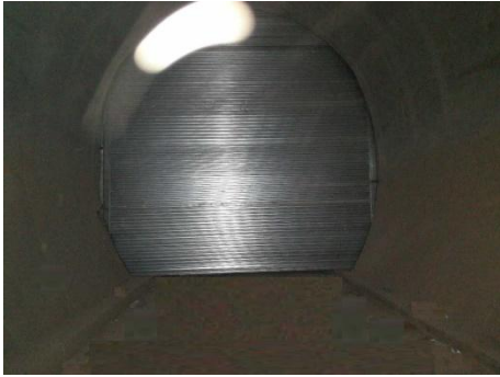
7.6.4-3 隧道车行横洞防火门
