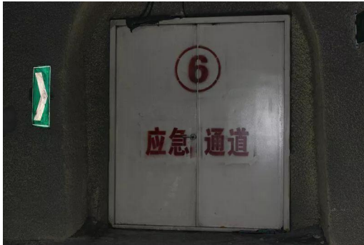
7.6.4-4 隧道人行横洞防火门
