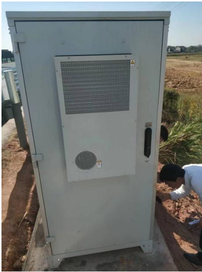
7.4.2-3 ETC 门架综合机柜 1
