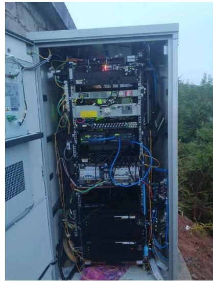
7.4.2-4 ETC 门架综合机柜 2
