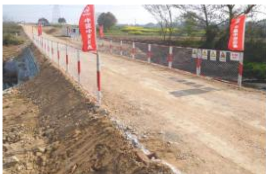
12.2-8 施工便桥防护标志
